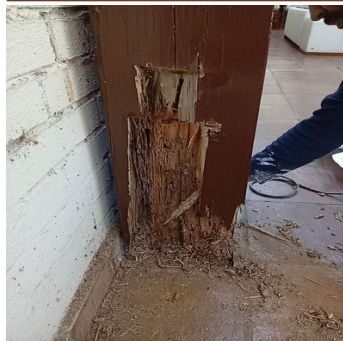
① Daño detectado
